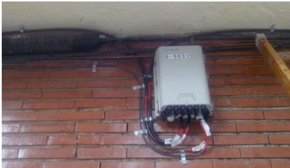
Ilustración 20. Detalle de la Caja terminal óptica (CTO) exterior.
