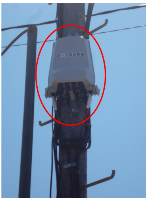
Ilustración 23. Caja terminal óptica (CTO) instalada en Poste.
