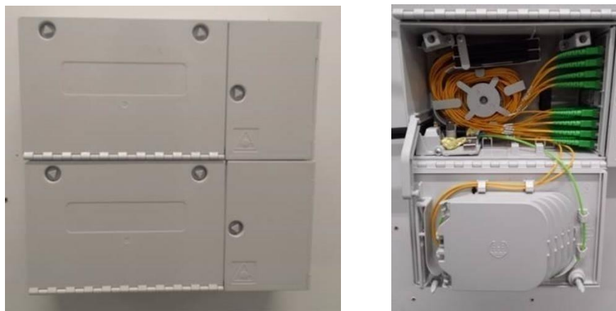
Ilustración 17-2. Caja terminal óptica (CTO) interior, con tamaño y nº de usuarios reducido.
