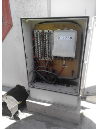
Ilustración 24. Caja terminal óptica (CTO) instalada en Pedestal.
