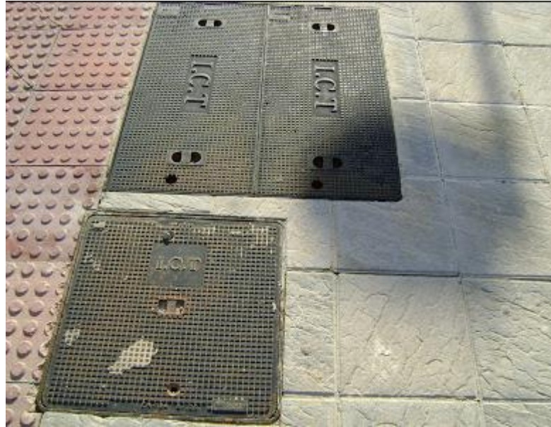
Ilustración 15. Arqueta de entrada a edificio con despliegue interior.
